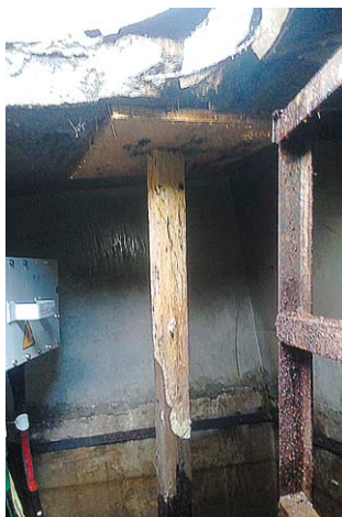
◀ Фото 3 Обрушение потолка бетонного колодца
