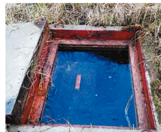
▲ Фото 2 Бетонный колодец, заполненный водой
